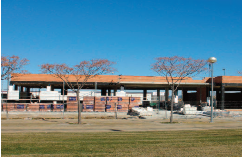
Obras del nuevo Centro de Día para personas dependientes en D. Benito (Badajoz)
